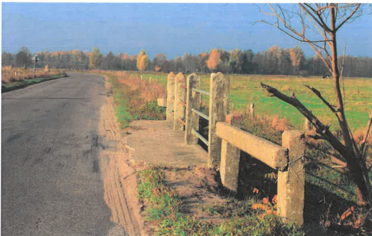
Zniszczony przepust na drodze powiatowej 1504N
