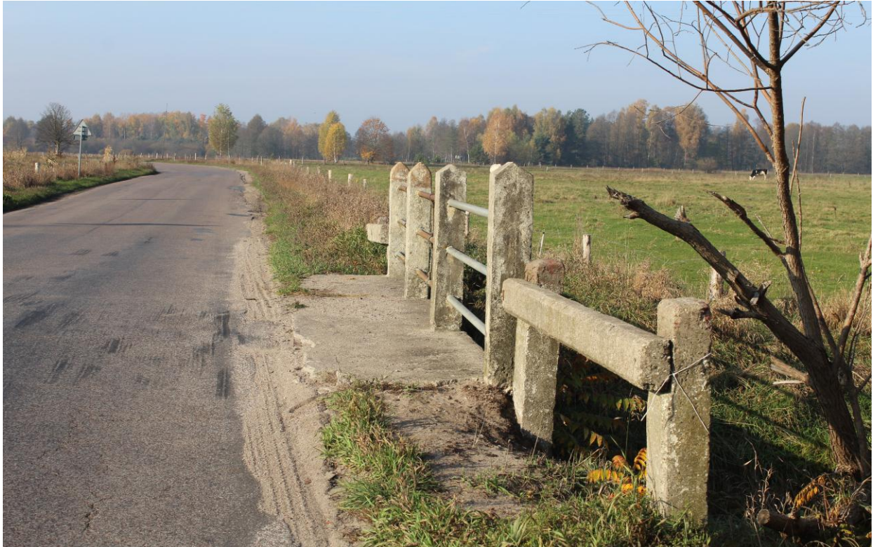
Zniszczony przepust na drodze powiatowej 1504N
